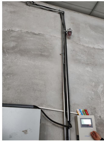
锅炉报警装置
